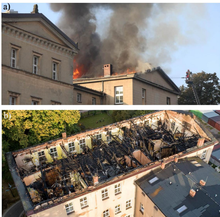
Rys. 17. Pożar (a) i uszkodzenia (b) dachu szkoły w Lublińcu
