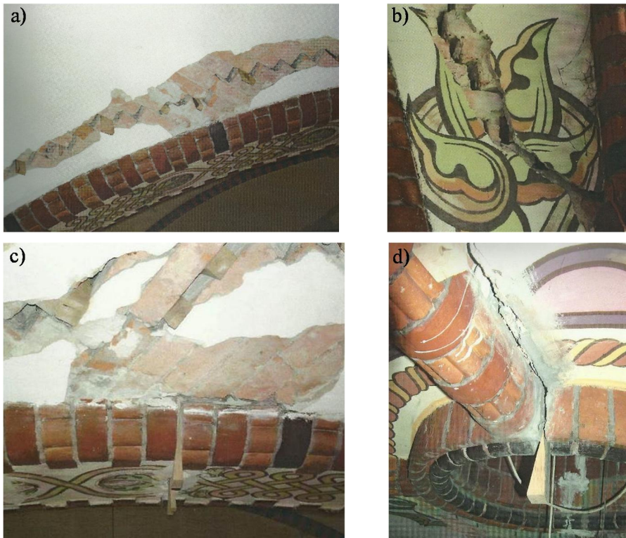
Rys. 12. Szczegóły zarysowań sklepień kościoła w Rudzie Śląskiej – Kochłowicach – 2005 r.: a) i b) zarysowania, c) zaklinowane rysy łuku jarzmowego i wysklepki, d) zaklinowane rysy w zworniku.
