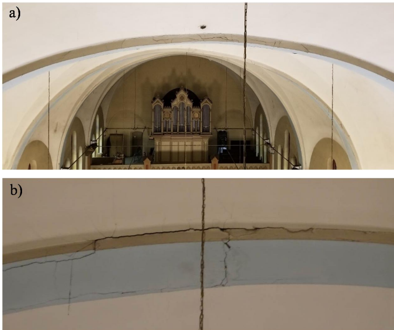
Rys. 28. Deformacja (a) i zarysowania (b) sklepień Rabitza w kościele św. Jana i Pawła Męczenników w Katowicach.
