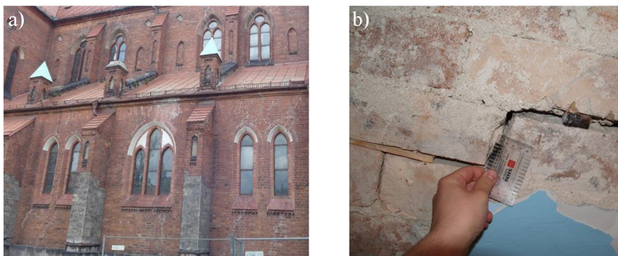
Rys. 14. Zarysowania konstrukcji kościoła w Rudzie Śląskiej – Wirku: a) widok naprawionych zarysowań ścian, b) zaklinowane rysy na wysklepce sklepienia.
