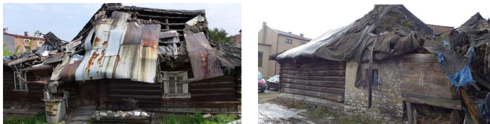
Rys. 5. Zawalony pod ciężarem śniegu dach XIX w. budynku w Chełmie Śląskim.
